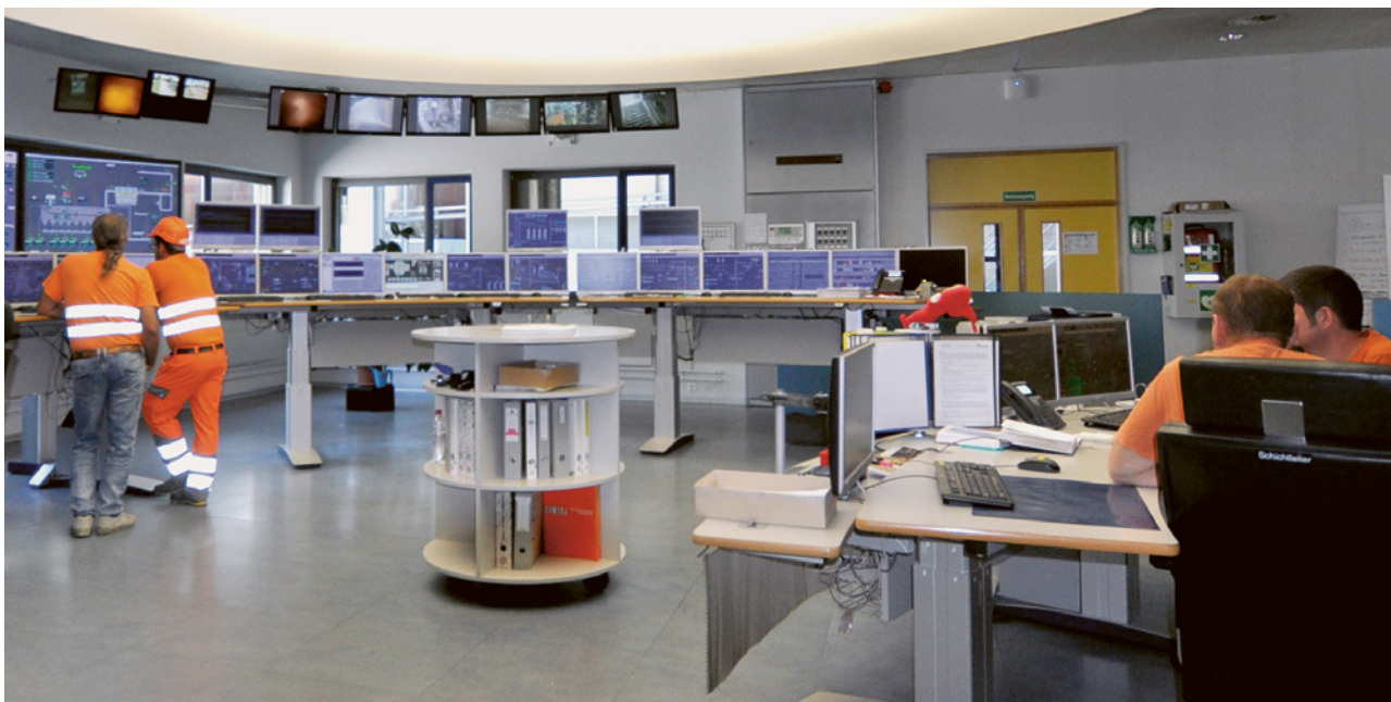
Das Leitsystem im Kontrollraum überwacht permanent die Abluft.
